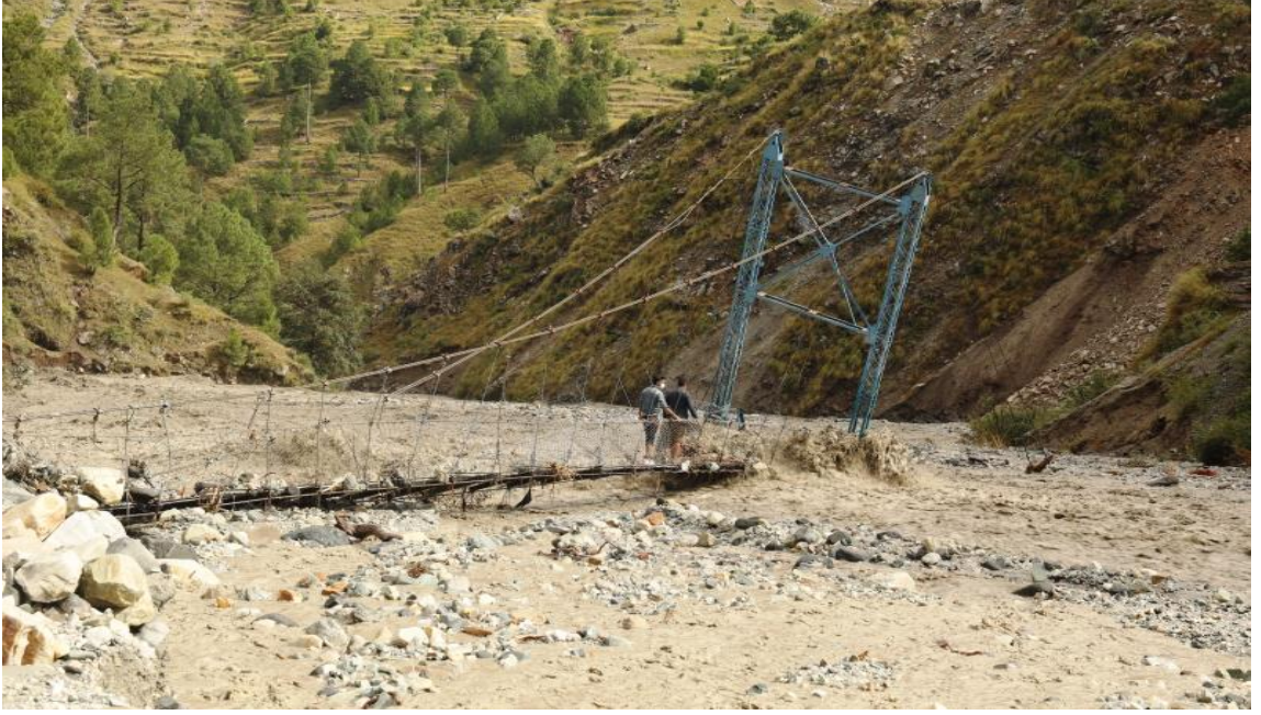
बाढीबाट क्षतिग्रस्त झोलुङ्गे पुल
